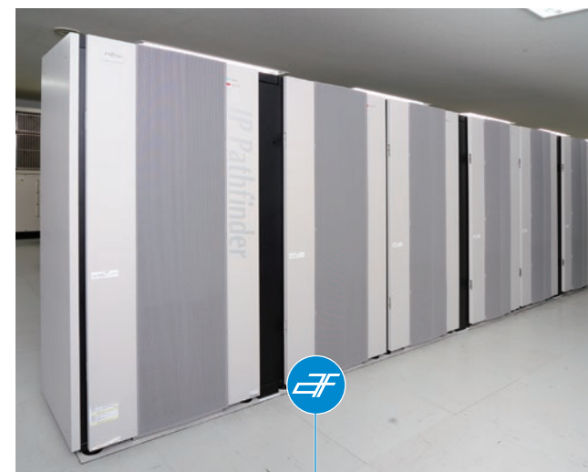
共用通信サーバー Shared communication server
