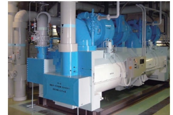
省エネ対応の高効率冷凍機
