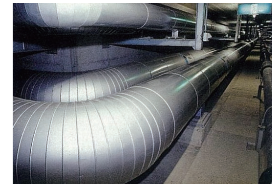
地域配管(共同溝内)
