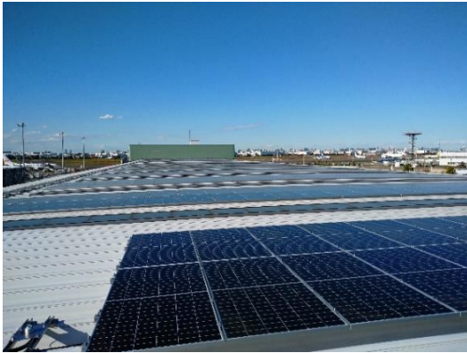
【貨物地区太陽光パネル】
