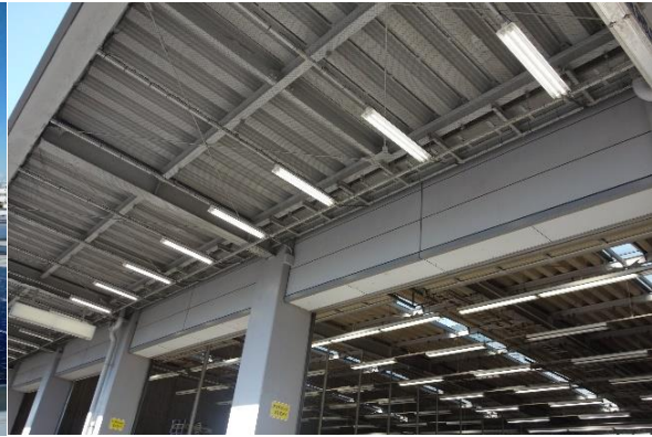
【貨物地区 LED 照明】
