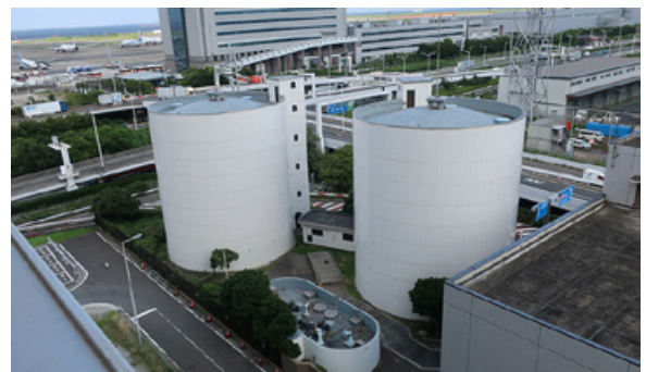
羽田空港給排水設備
