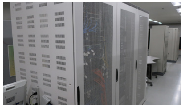
羽田空港共用通信設備
